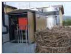
Monte Vibiano, boiler
